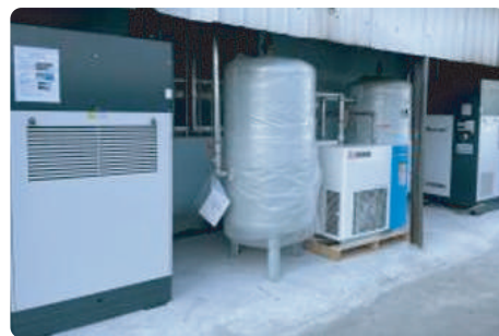
伺服節能空壓機 (2023.12.29安裝完成)
